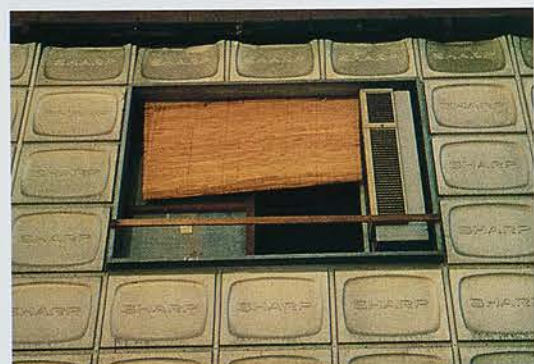
「壁のテレビ、窓のテレビ」ただのブロック壁みたいだけど、よく見ると枠がみんなひと昔前のブラウン管の形をしている。この窓自体もどこかテレビに見える。香川県の高松にて。
